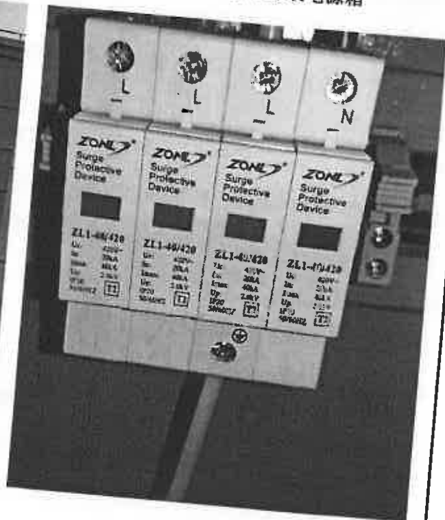
图 8 5#楼配电间配电柜 SPD
